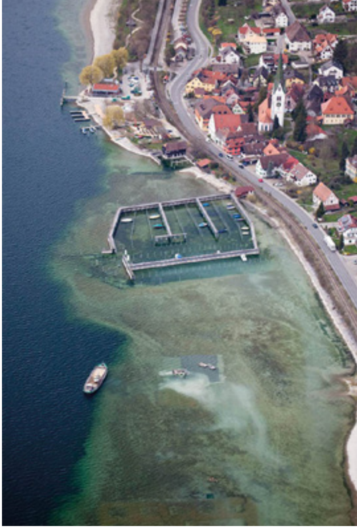
Sipplingen-Osthafen 2008. Seebürtiges Einbringen einer Kiesabdeckung auf Geotextilbahnen im Rahmen des Interreg IV-Projektes.
